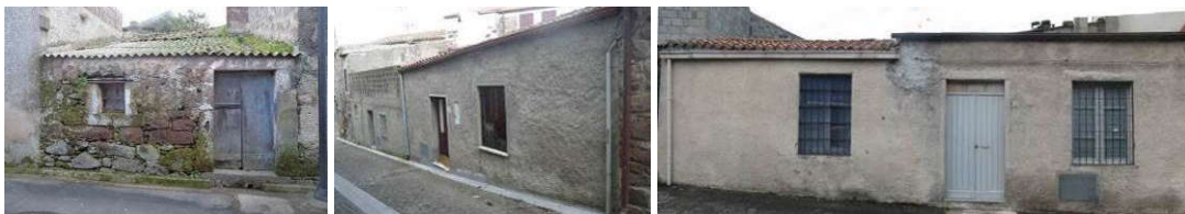
Varianti Tipologia B - B1 – Isolato 14 Unità j / B2 - isolato 28 unità d / B3 - isolato 14 unità j
